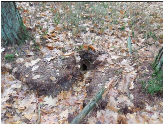
Foto B1.3 Op diverse plekken is het talud rond de locatie vergraven door dieren
